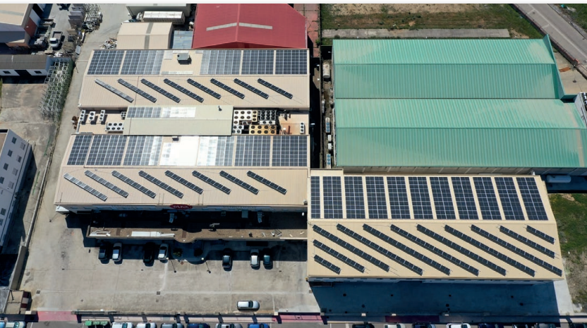
Instalación fotovoltaica realizada en Chacinerías Díaz, en Salamanca
