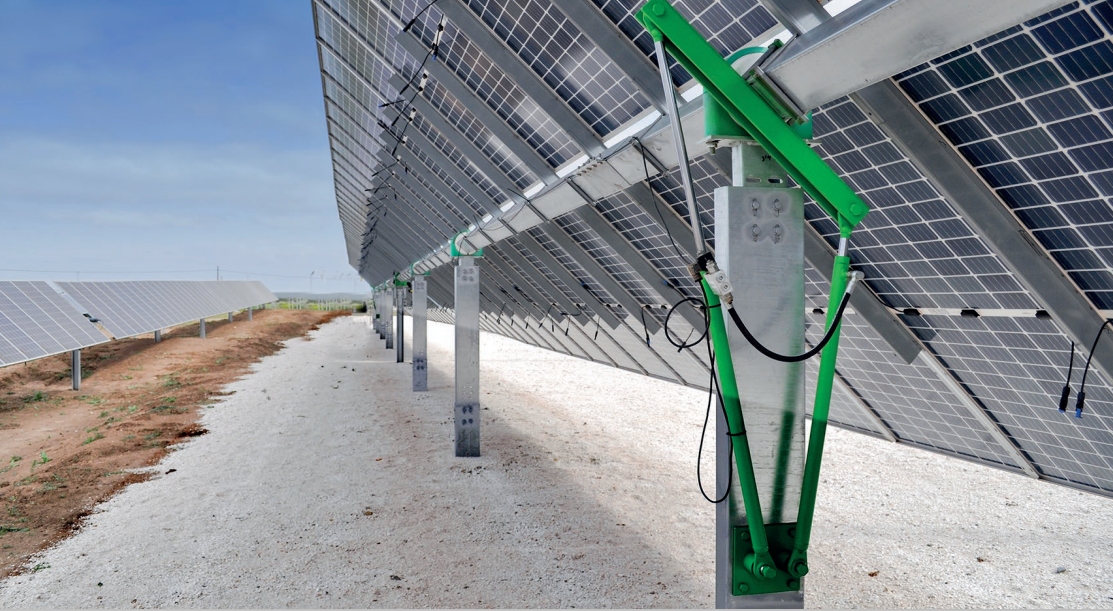
Seguidor solar dotado de sistema ESAblock. En la página siguiente, estructura fija
