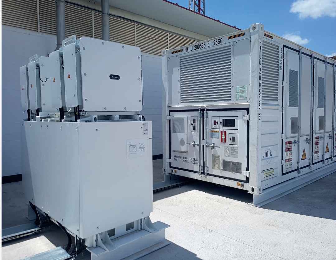
Típica instalación de almacenamiento de 2 MWh, suministrada por Wattkraft en 2023
