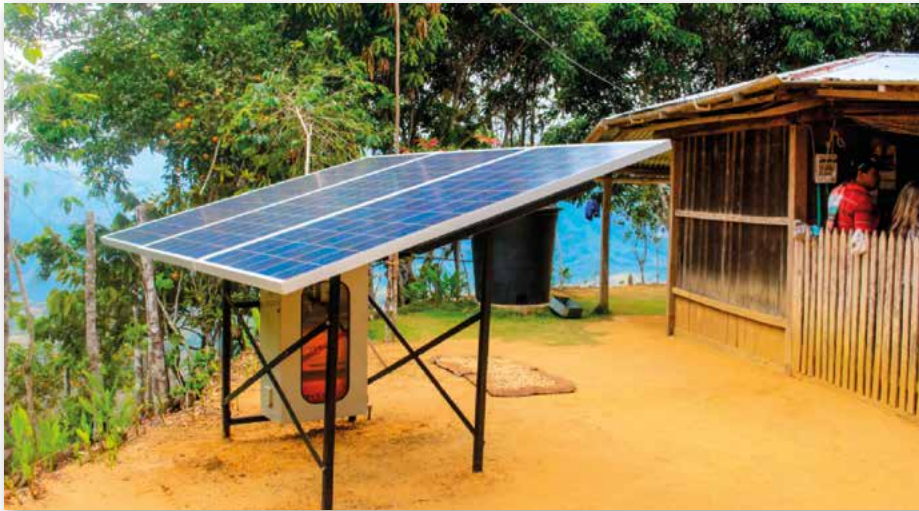
Instalación de autoconsumo y portada del plan Crego3o, en Colombia. Debajo, instalación en Aguascalientes, México.
